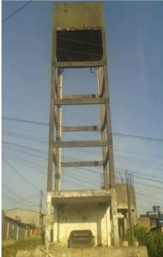
Figura 11 – Vista frontal do reservatório elevado em alto estado de degradação
