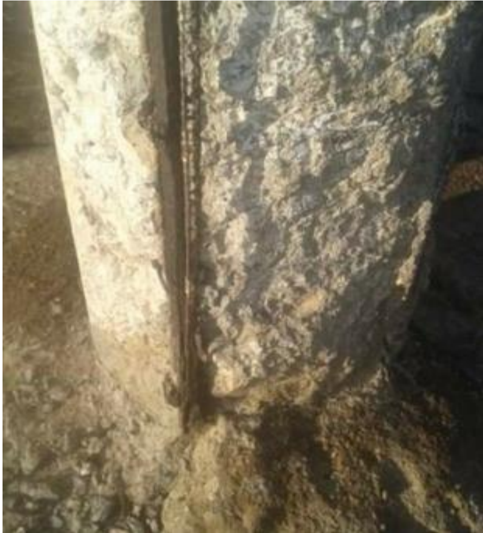
Figura 12 – Armadura dos pilares expostas
