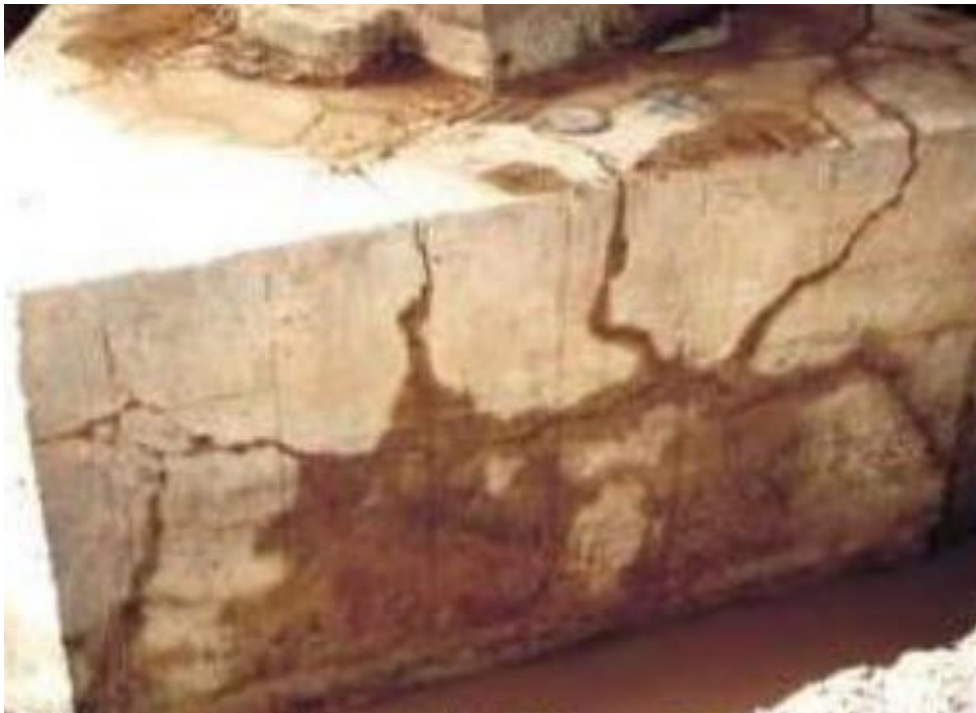
Figura 4 – Estrutura comprometida por reação álcali-agregado
