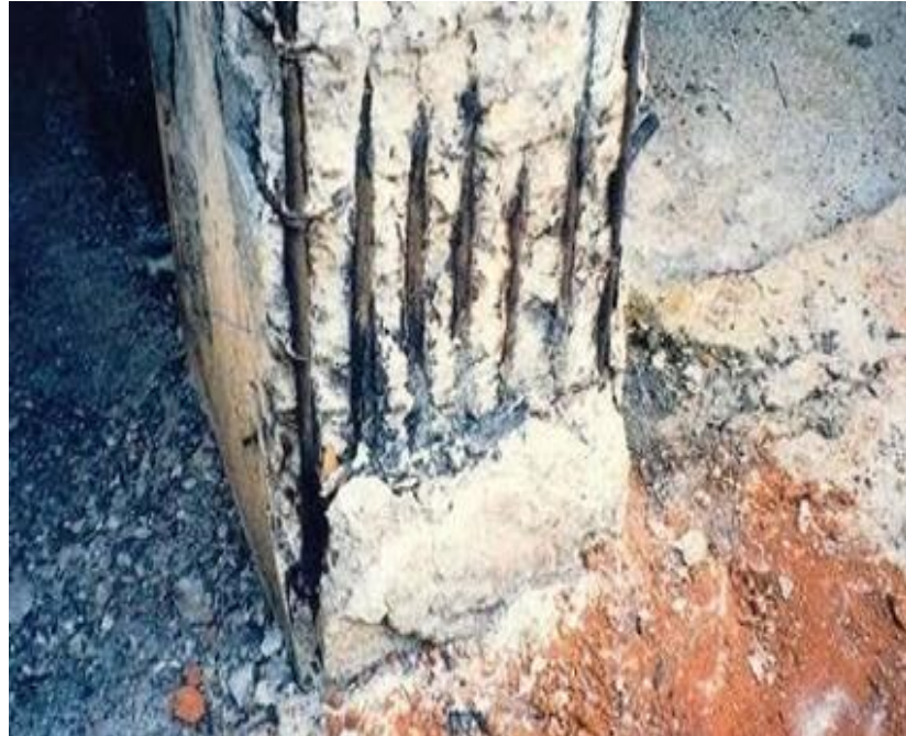
Figura 6 – Sistema estrutural comprometido
