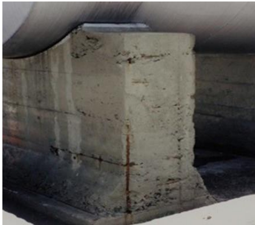
Figura 2 – Corrosão no concreto
