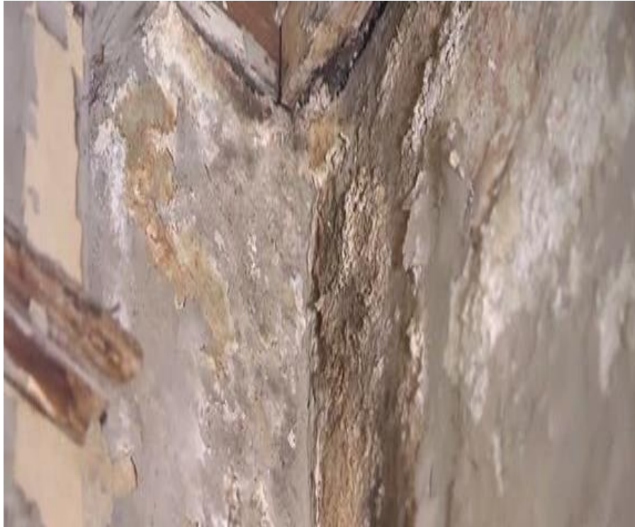
Figura 5 – Infiltração no concreto
