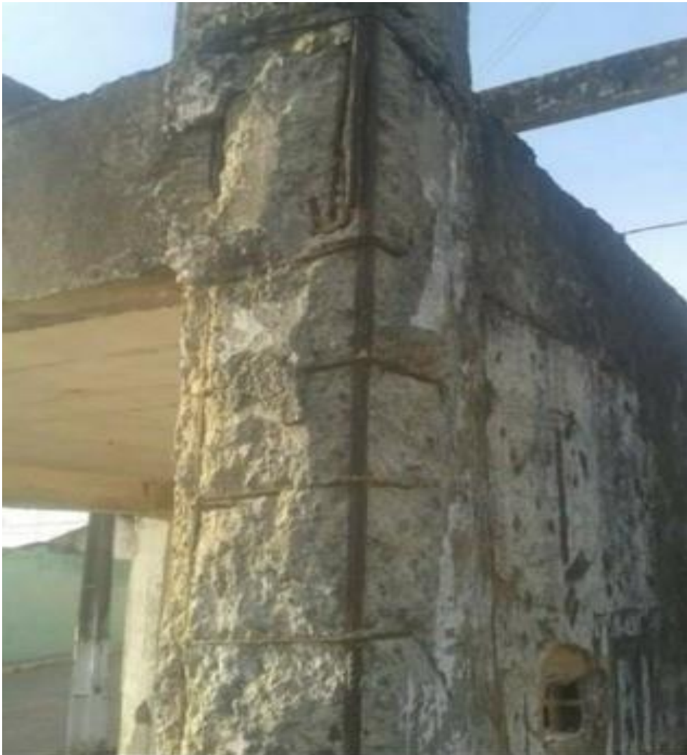
Figura 13 – Desagregação do concreto
