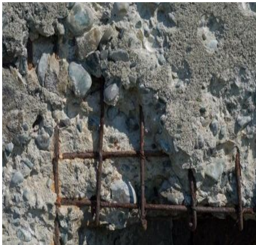
Figura 3 – Carbonatação na Estrutura
