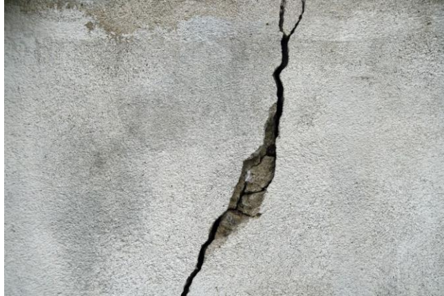
Figura 5- Rachaduras em edificações.
