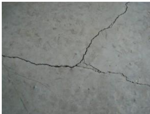
Figura 2- Fissura em edificação.
