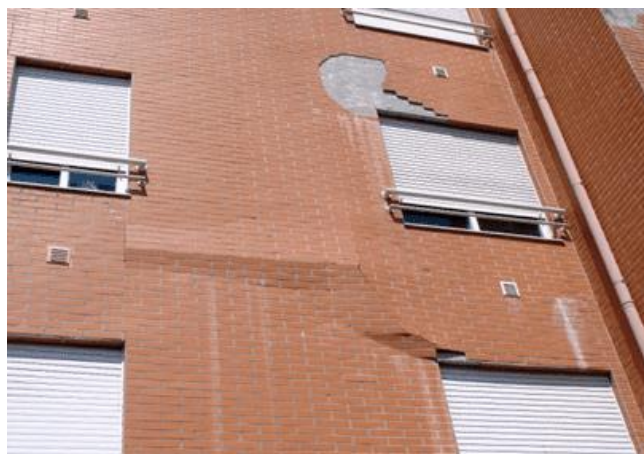
Figura 4- Desplacimento de fachada.
