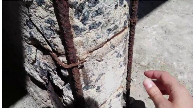
Figura 7- Corrosão de armadura.
