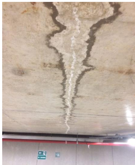
Figura 6- Infiltração do concreto.
