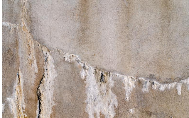
Figura 3- Eflorescência em edificações.
