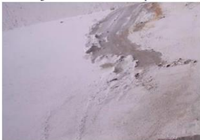
Figura 17 – Descascamento de pintura
