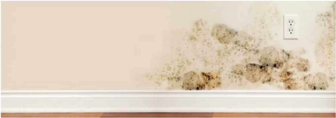
Figura 15 – Mofo próximo ao rodapé
