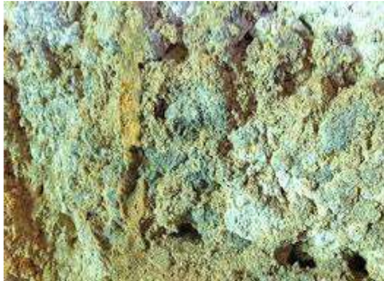
Figura 7: Biodeterioração do concreto.
