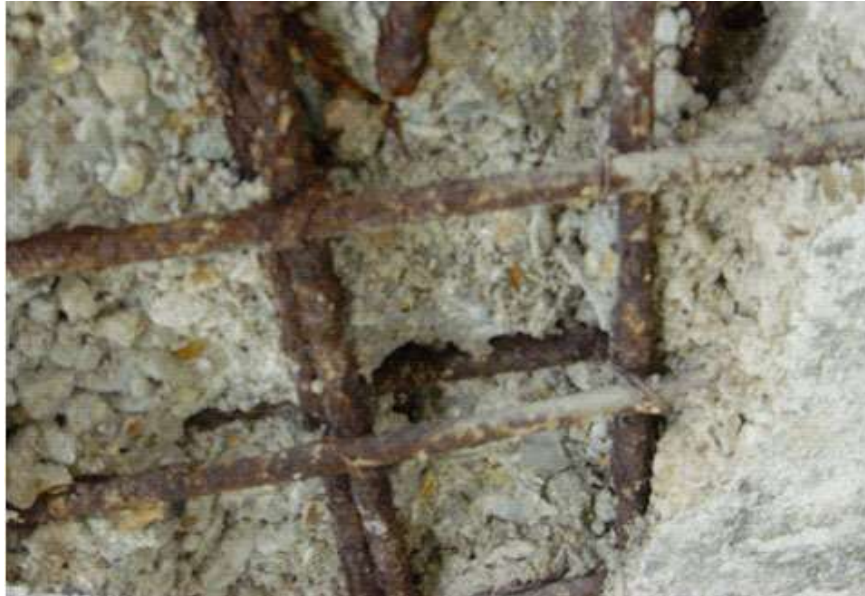
Figura 8: Corrosão das armaduras no concreto armado.
