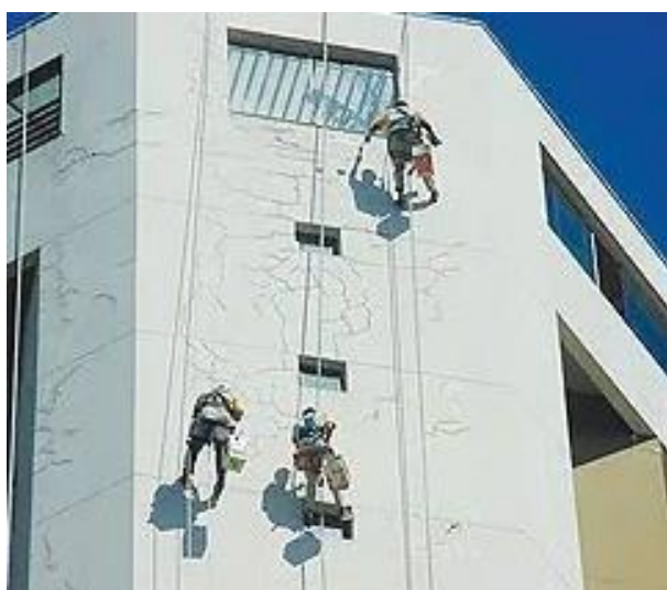
FIGURA 3 – Fissura mapeada causada por retração de secagem da argamassa.
