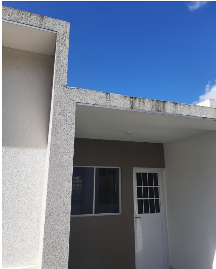
FIGURA 9: Manchas e bolor na pintura
