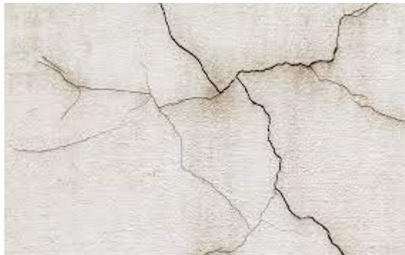
Figura 02: Trincas e Fissuras
