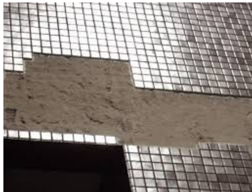
Figura 01: Descolamento ou destacamento
