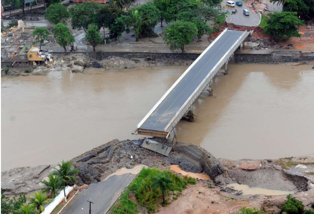
Figura 4: Ponte Lucia Paiva- sobre o Rio Una em Palmares - PE logo após a enchente
