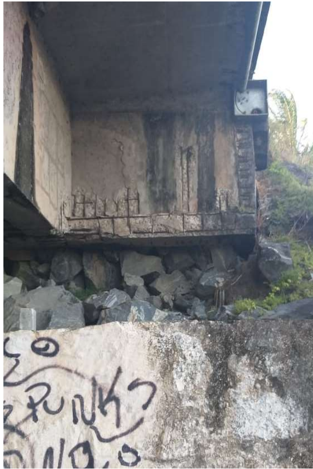
Figura 12: Desagregação do concreto e corrosão da armadura
