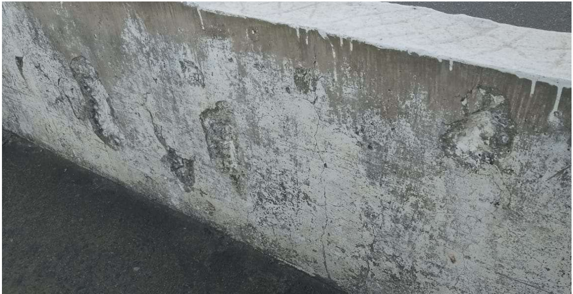
Figura 14: Desplacimento e fissuras na defesa de proteção de forma mais detalhada
