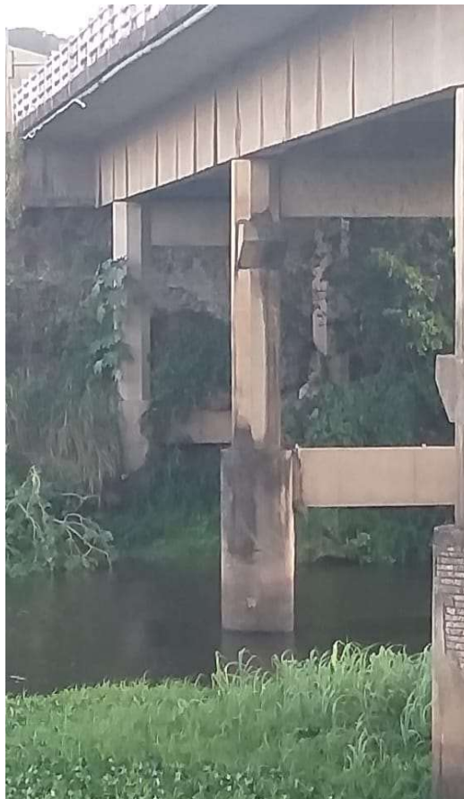
Figura 15: Mancha por ocorrência de umidade no pilar
