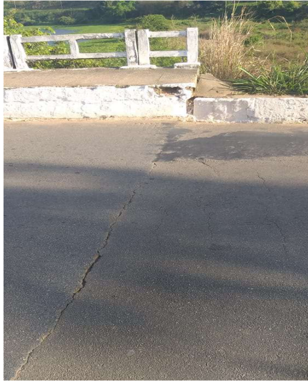
Figura 22: Desplacamento na extremidade da ponte
