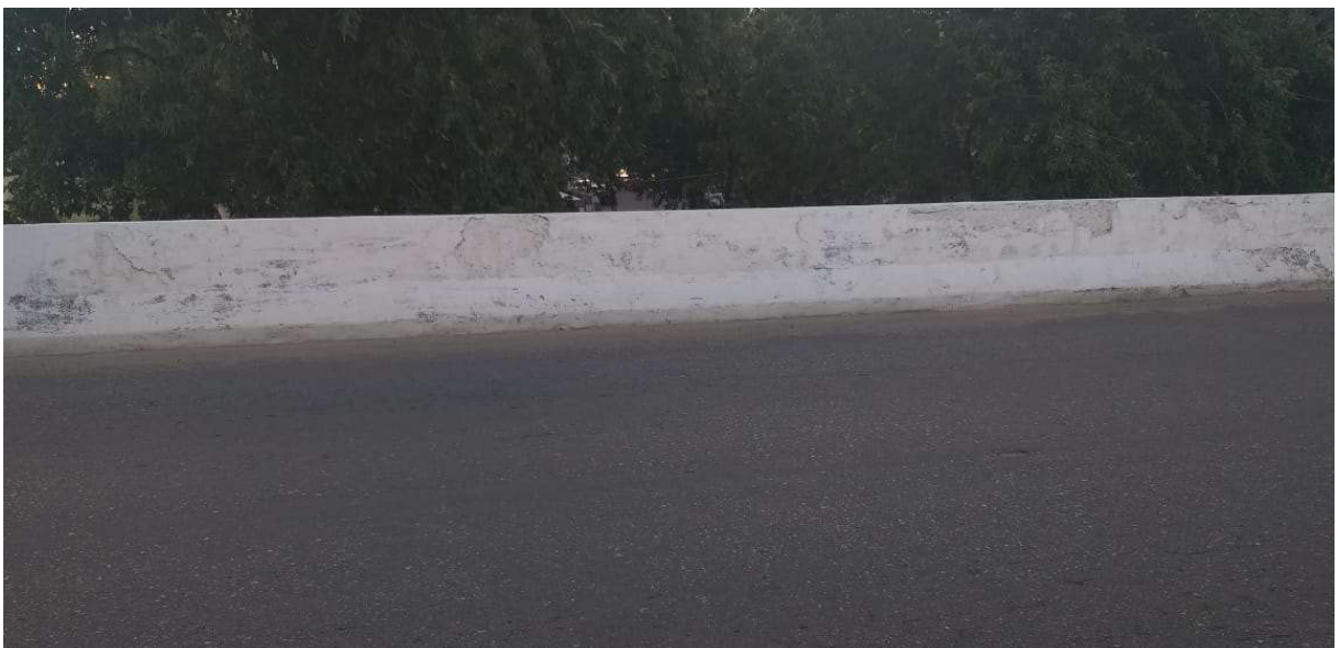
Figura 13: Desplacimento e fissuras na defesa de proteção
