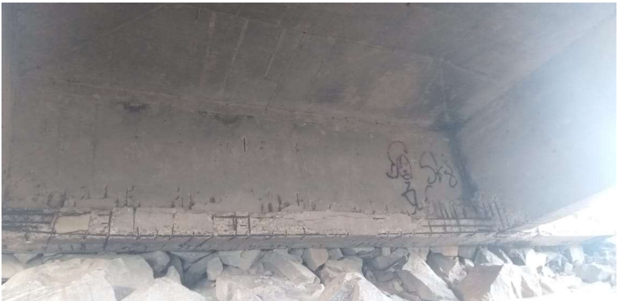
Figura 17: Corrosão da armadura
