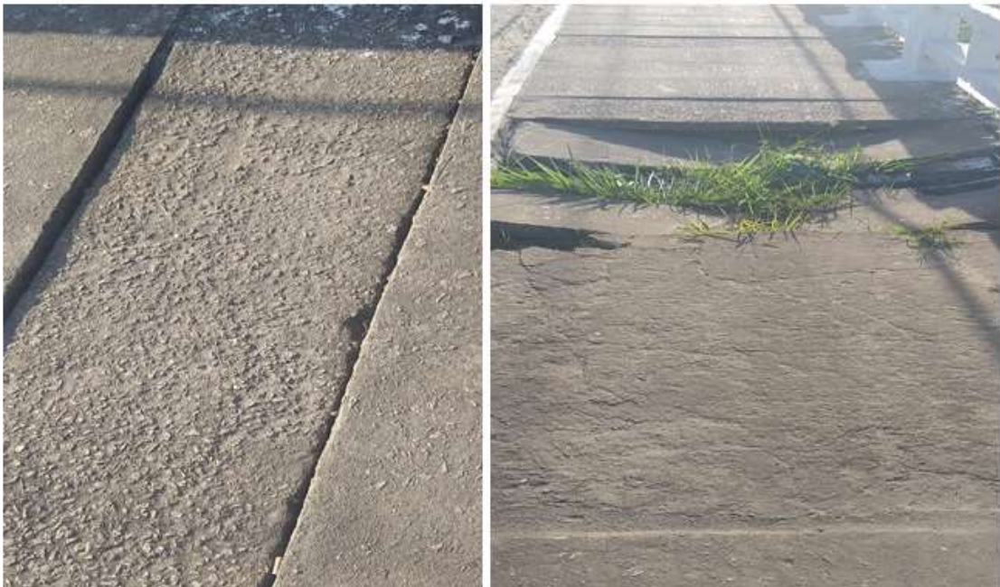
Figura 23: Afundamento de calçada
