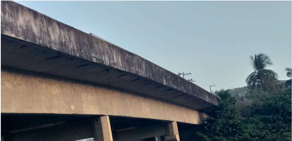
Figura 10: Presença de manchas decorrente da umidade na estrutura
