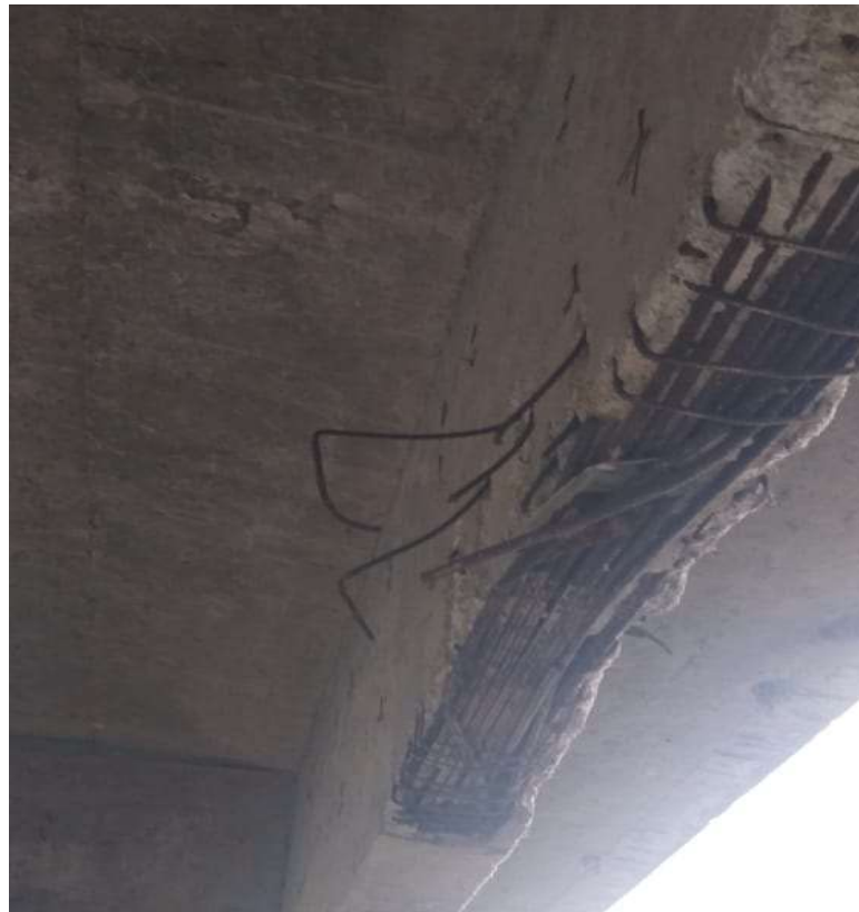
Figura 11: Dano estrutural decorrente a colisão de caminhão na viga da estrutura
