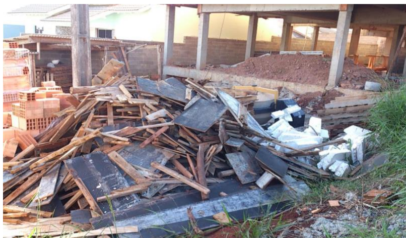
Figura 02 - Canteiro de obras sem definição pra materiais e resíduos
