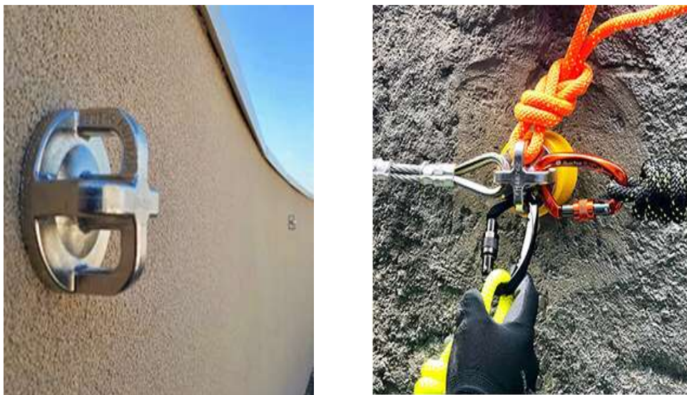
Figuras 6a e 6b: Ponto de espera de ancoragem fixa na platibanda.
