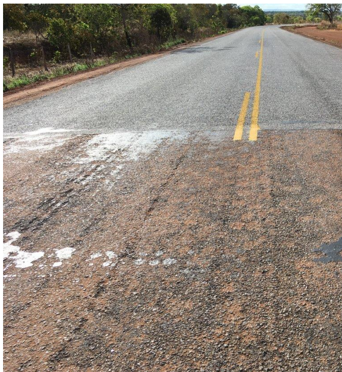
Figura 12 – Desgaste do asfalto
