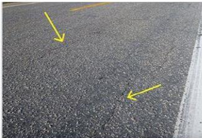
Figura 04 – Fissuras no pavimento asfáltico
