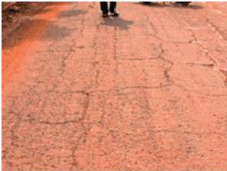
Figura 07 – Trincas do tipo bloco
