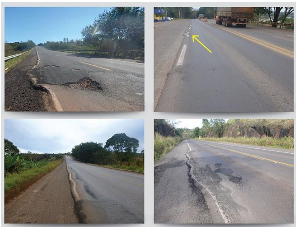
Figura 13 – Escorregamento do asfalto
