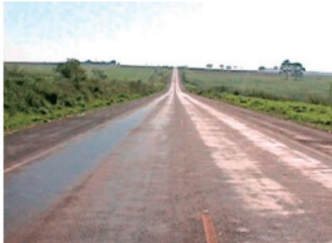
Figura 10 – Exsudação de asfalto
