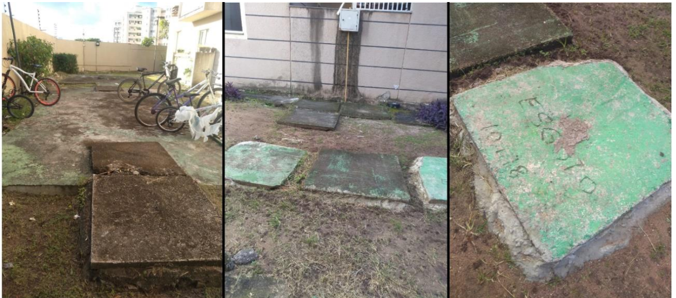
Figura 2 – Fossas sépticas do edifício.
