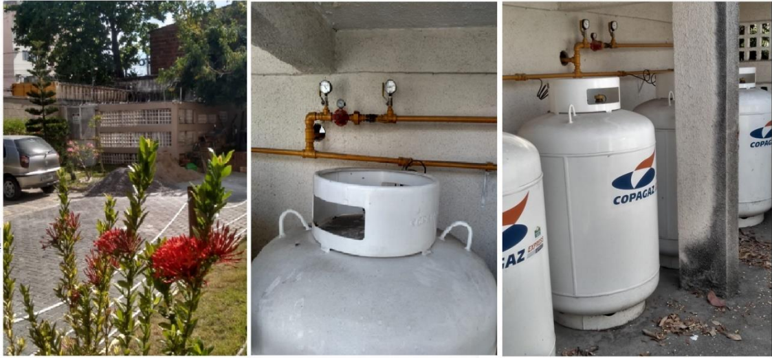
Figura 3 – Local para armazenamento do gás e suas tubulações.
