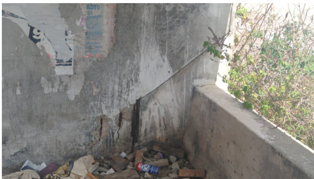
Figura 35 - Detalhe da corrosão no pilar apoio da rampa de acesso à passarela
