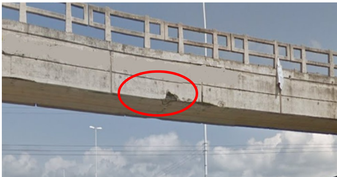
Figura 31 - Corrosão de armadura passarela em Bezerros
