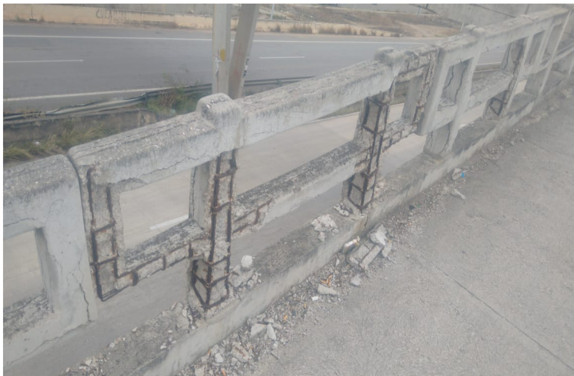
Figura 33 - Corrosão, montante guarda-corpo
