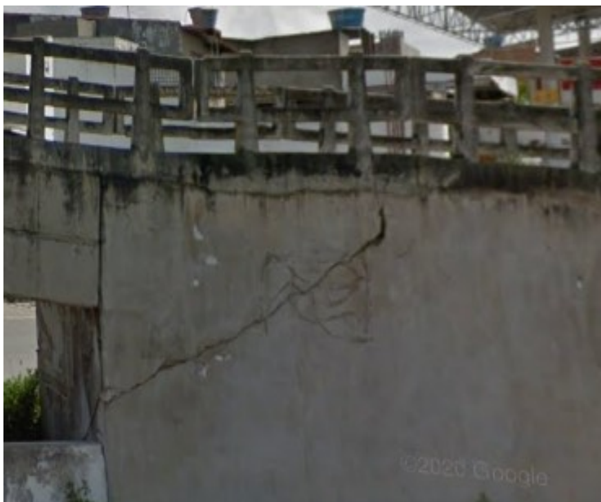
Figura 29 - Fissura estrutura de encontro da passarela
