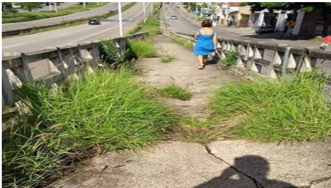
Figura 36 - Deformações, trincas e vegetação no piso.
