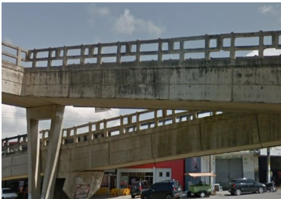
Figura 30 - Manchas na superfície do concreto na passarela em Bezerros
