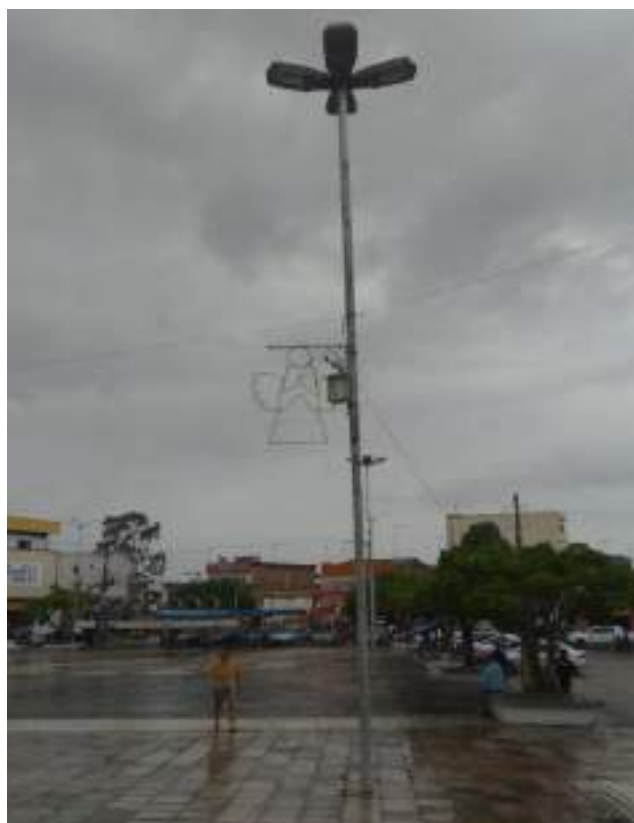
Figura 30 - Poste de iluminação
