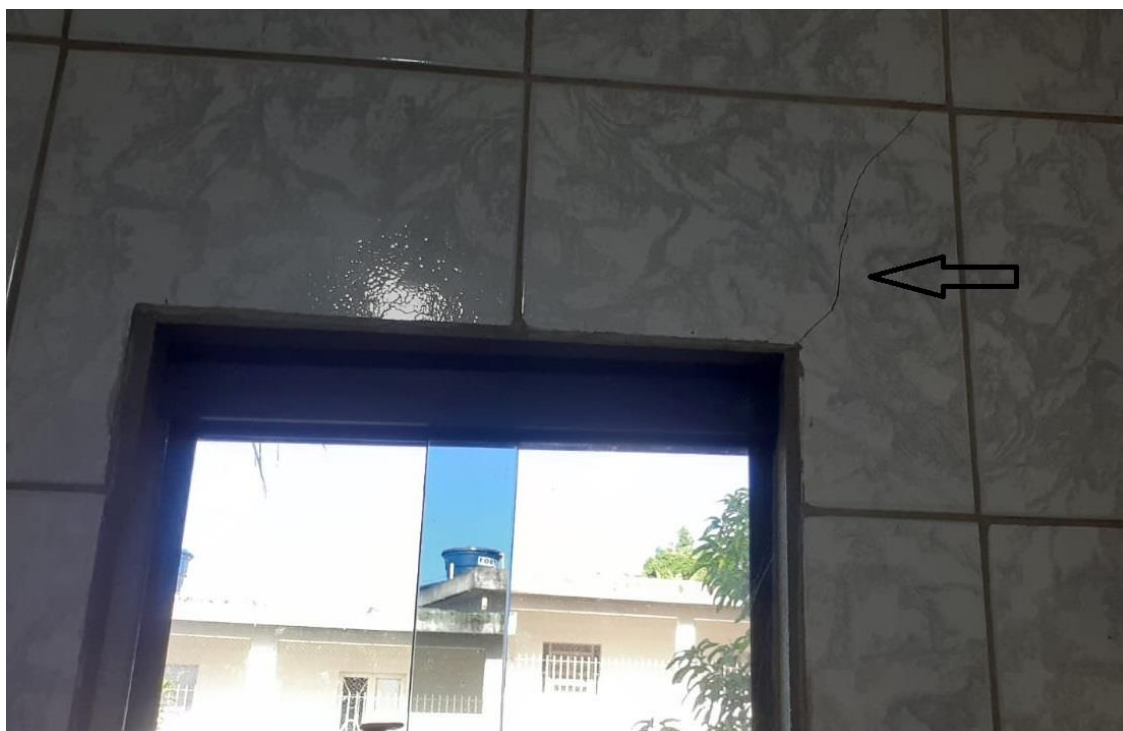
FIGURA 20 - Fissura no ângulo de 45° na quina superior em uma janela.
