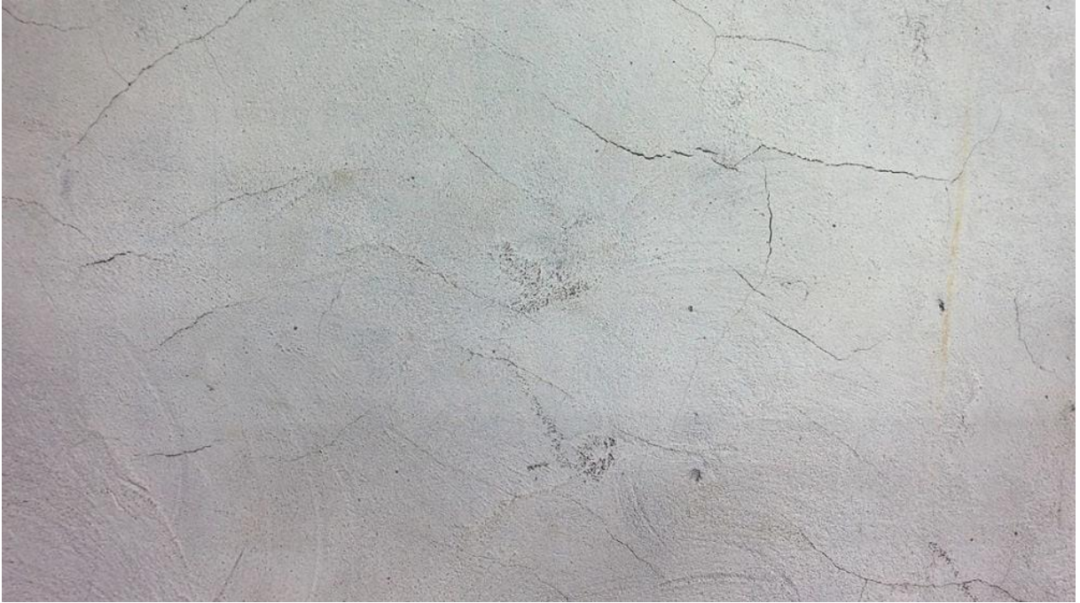
FIGURA 15 – Fissura por retração da argamassa
