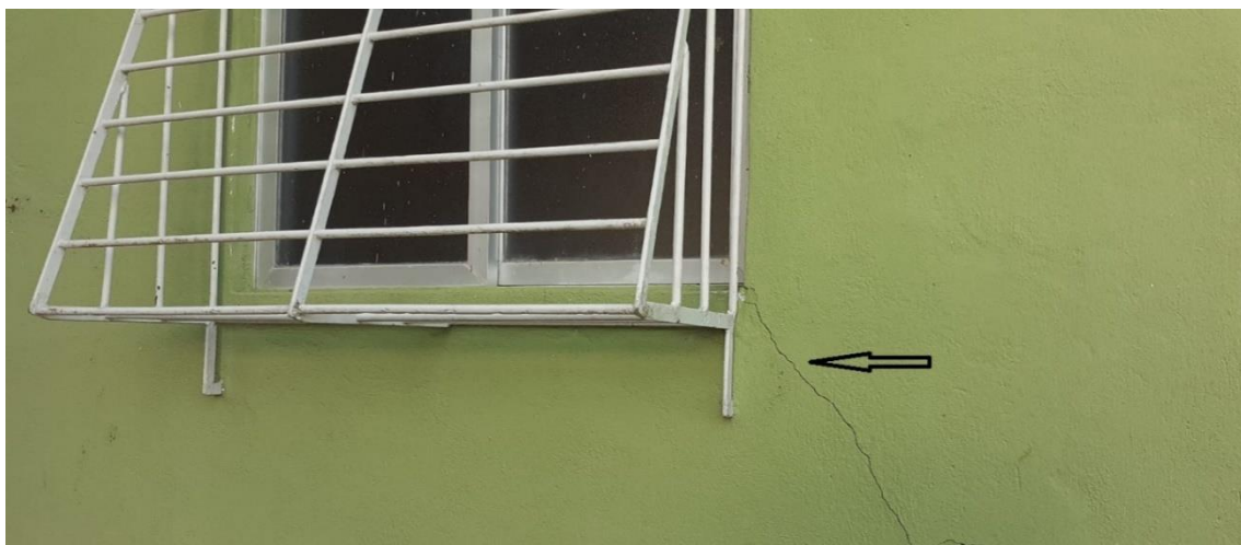
FIGURA 19 - Fissura no ângulo de 45^\circ na quina inferior em uma janela.
