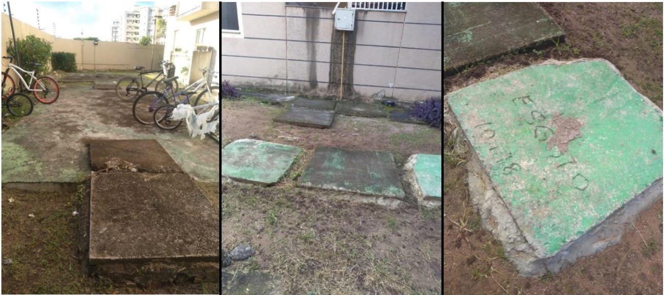
Figura 2 – Fossas sépticas do edifício.
