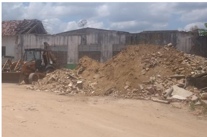
.Figura 13: Local onde são depositados os resíduos de construção civil (RCC)
